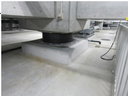
庁舎基礎の下の免震・制震装置／半田市
