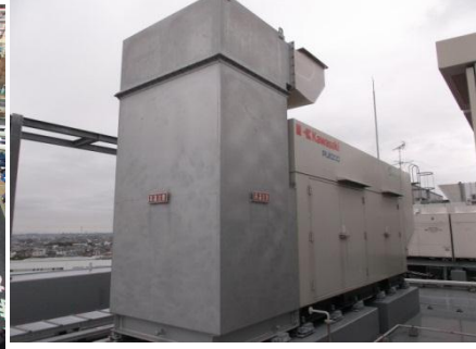
災害時の電力確保ができる自家発電装置／刈谷市
