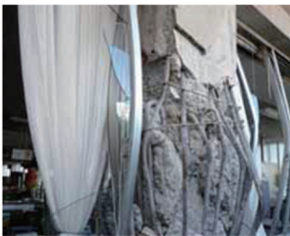
被災した須賀川市役所 (柱のせん断)
