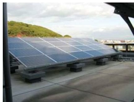
事例：太陽光パネル（小牧市）
