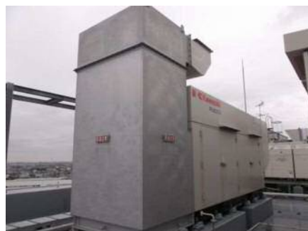
事例：自家発電装置（刈谷市）
