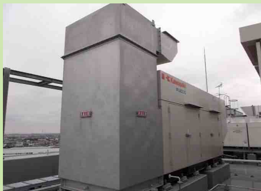
事例: 自家発電装置(刈谷市)
