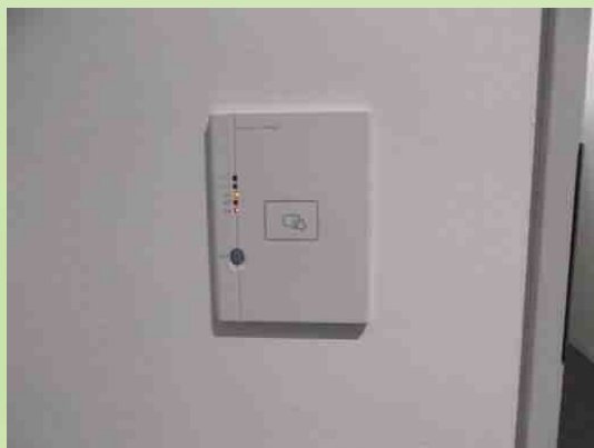
事例:ICカード認証(甲府市)
