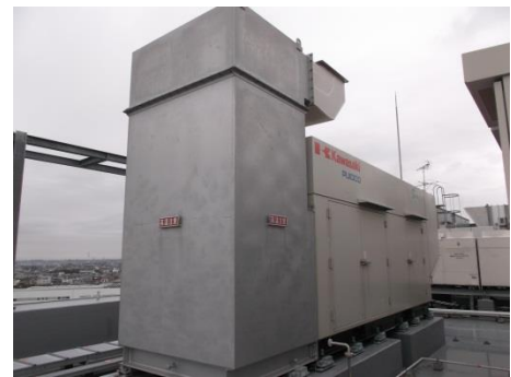
事例：自家発電装置（刈谷市）
