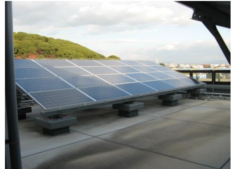
事例：太陽光パネル（小牧市）
