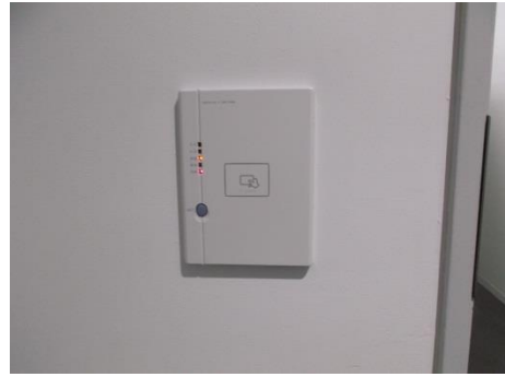
事例：ICカード認証（甲府市）
