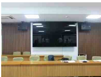
災害対策本部室の大型モニター
