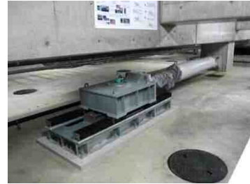
免震装置（接続型スイッチダンパー）
