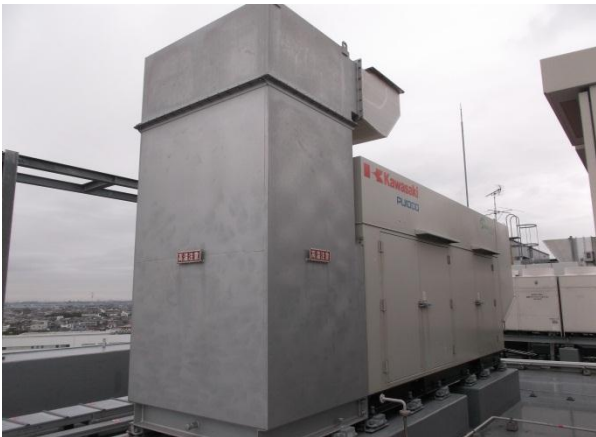
自家発電装置
