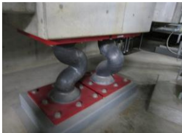
免震装置(鉛ダンパー)
