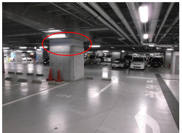
地下駐車場、免震装置
