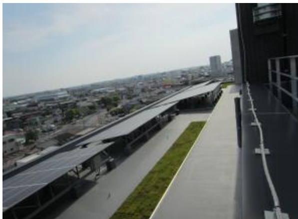
太陽光パネル
