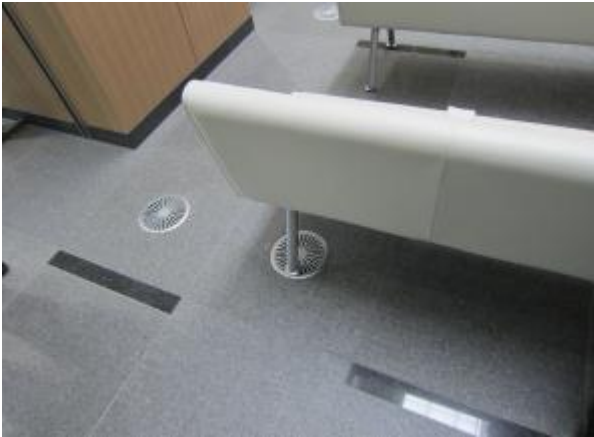
エコボイド下の床からの送風口
