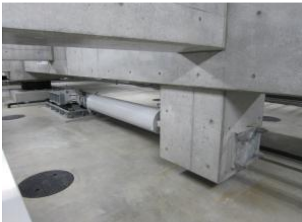
免震装置と制震装置
