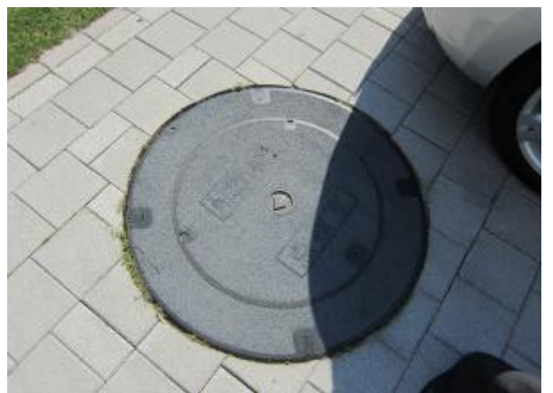
耐震性貯水槽
