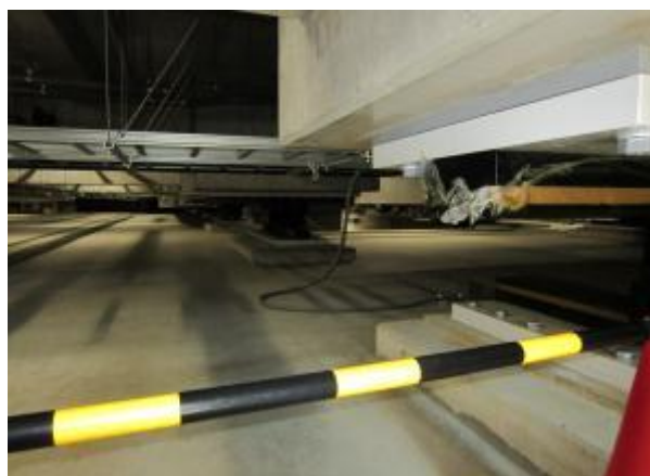
地下免震ピット
