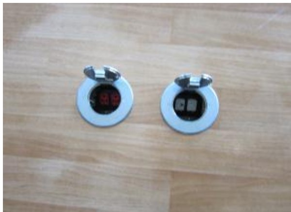
電源やネットワークに接続できる食堂床
