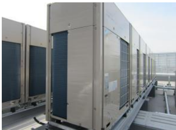
機械類は屋上に設置
