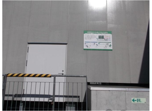
コージェネレーション設備
