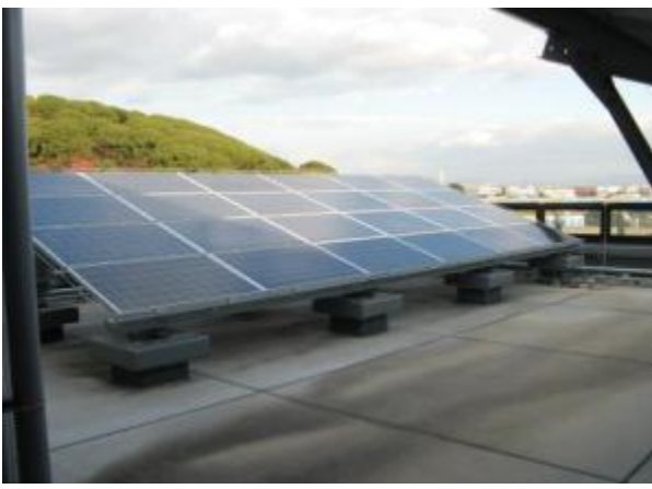
太陽光パネル
