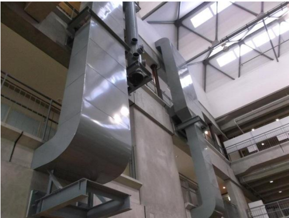
むき出しのダクト
