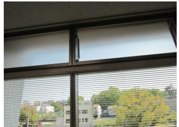
網戸付きの換気・排煙用窓
