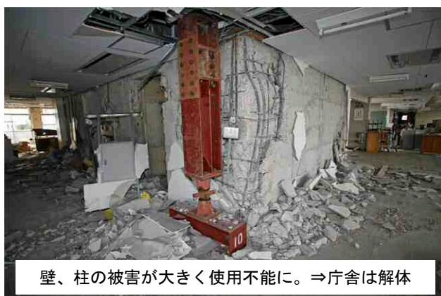
東日本大震災後の福島県須賀川市役所 (写真：須賀川市 HP 須賀川市内における被災状況より)
