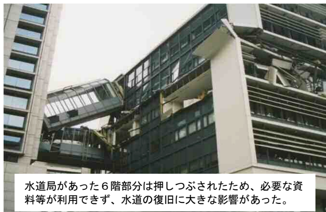
阪神淡路大震災後の神戸市役所 2 号館 (出典：地震発生時における地方公共団体の業務継続の手引きとその解説 (内閣府))
