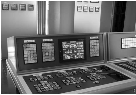
水道庁舎監視盤
