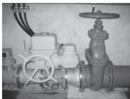
緊急遮断弁（八木山低区配水池）
