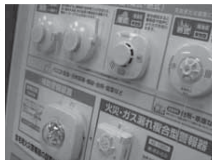
火災警報器啓発コーナー（本庁1階）
