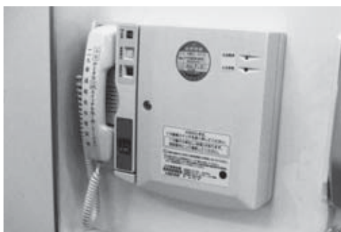
消防機関に通報する火災通報装置
