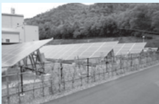
北清掃センターの太陽光パネル
