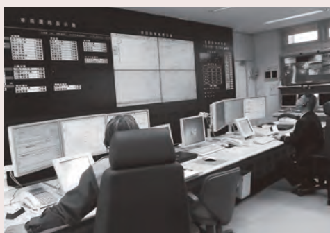
高機能消防指令センター（消防本部）
