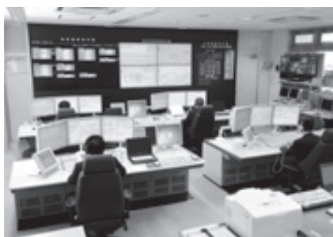
更新を行う高機能消防指令センター
