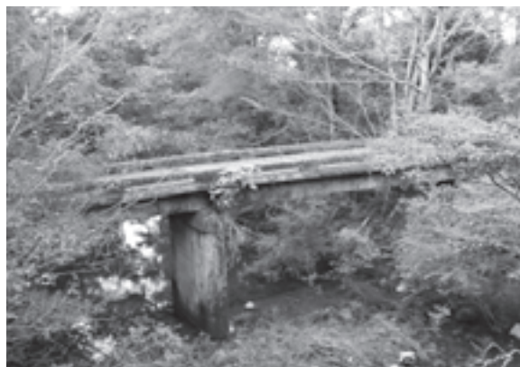
劣化が進み撤去される洞橋1号橋(各務東町)
