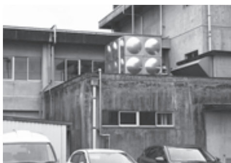
中央小学校の受水槽
