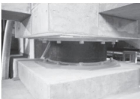
免震装置(福島市役所)
