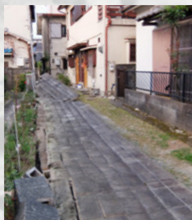
地震により倒壊したブロック塀(大阪府)
