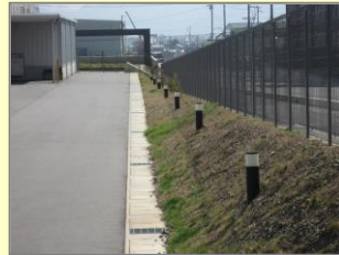
【 屋外照明を設けた事例 】
