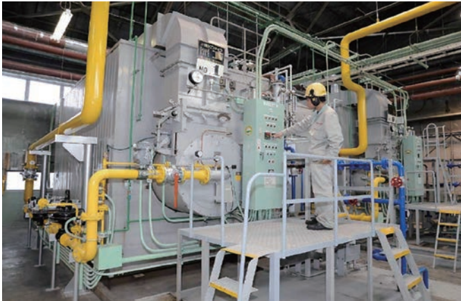
ボイラーの運転・保守
