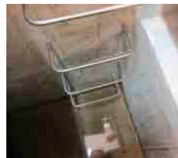
校舎地下の貯水タンク
