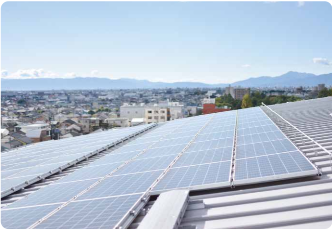
公共施設の再エネ設備
