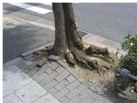
根上がりによる歩道の段差 (資料：名古屋市街路樹再生なごやプラン)
